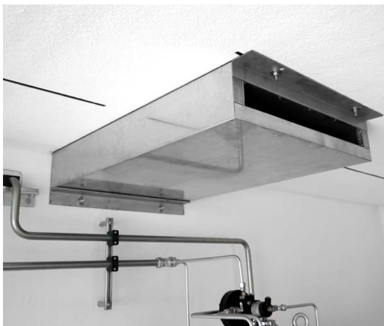
Lüftungselement mit schallgedämmtem Blechkanal
